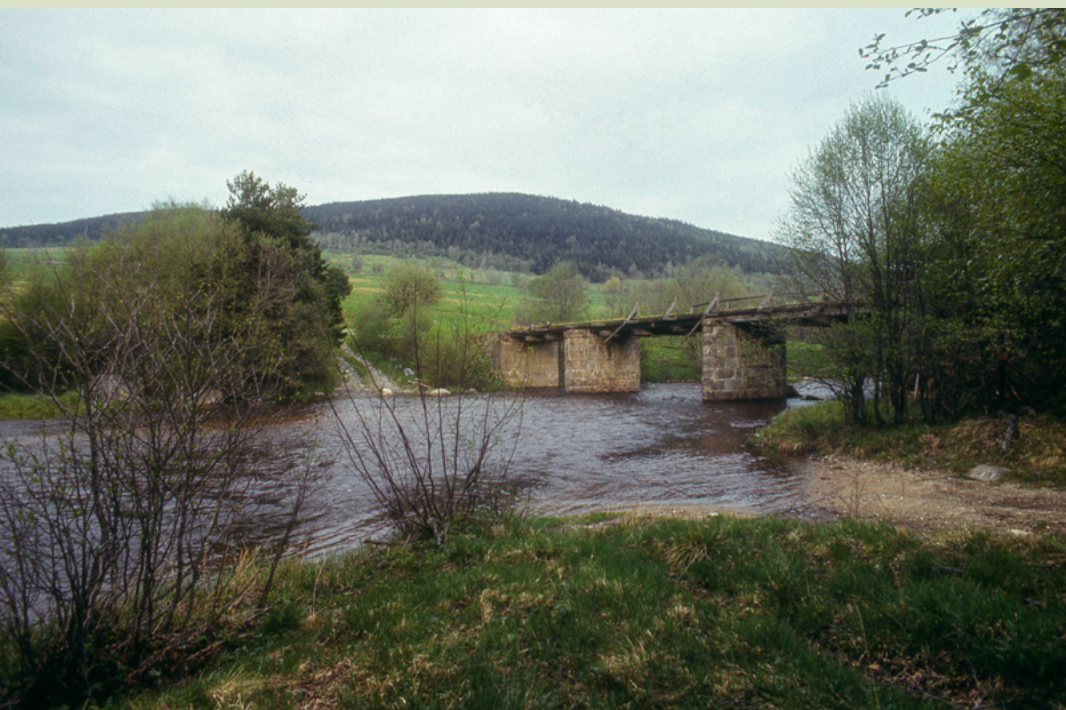
květen 1986 / Původní stodůlecký most byl v osmdesátých letech 20. století v dezolátním stavu
